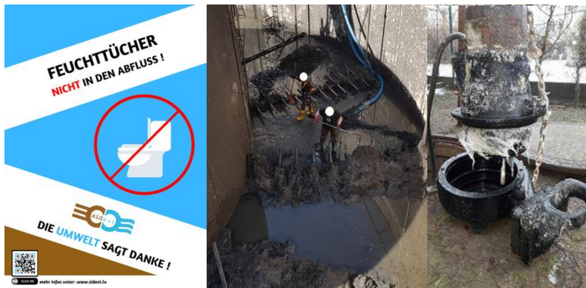
Abbildung 9: Hinweis des Abwassersyndikates SIDEST zur Problematik der Vliesstofftuchentsorgung mit der Toilettenspülung und Fotos zu Beeinträchtigungen der Abwasserreinigung durch solche Tücher (Quelle: SIDEST und Pent air -Jung Pumpen)
